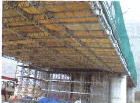
三重県内の橋梁工事で採用されたシステム吊り足場「クイックデッキ」
