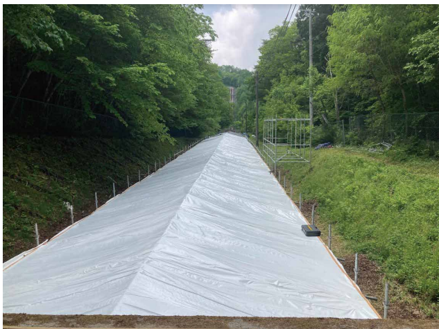
水圧鉄管 ▶ プラスト時の雨漏り対策にて使用（長野）
