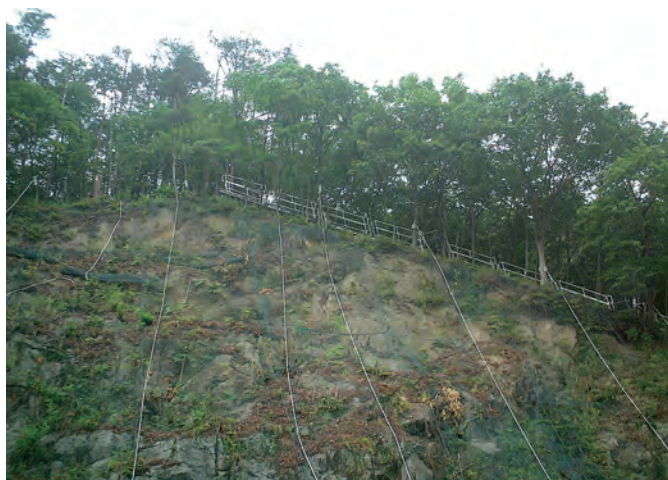
親綱点検用としての昇降設備
