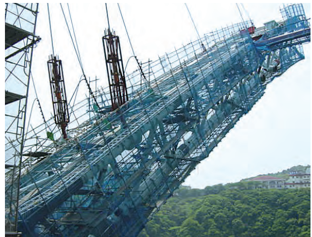
メタルアーチ橋での昇降設備(工事進捗により角度が変わる)
